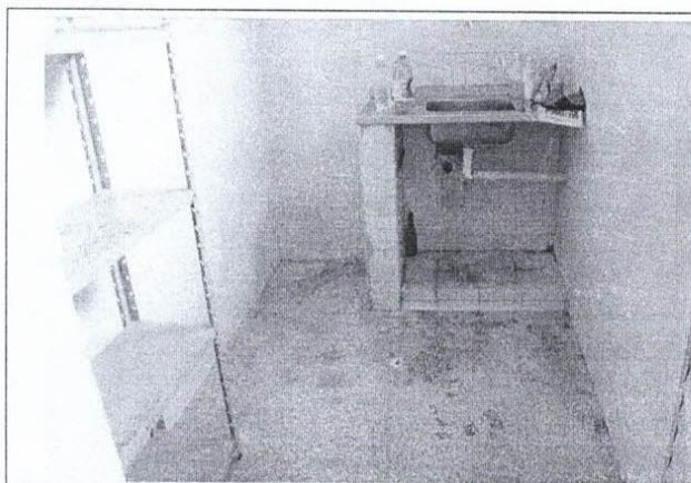
Foto1: apresenta sujeira e manchas no piso e no revestimento cerâmico, vazamento no ponto hidráulico.
