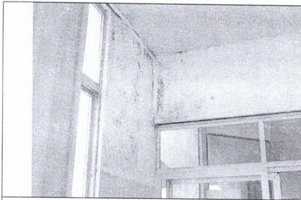
Foto 01: Infiltração entre parede e forro.
