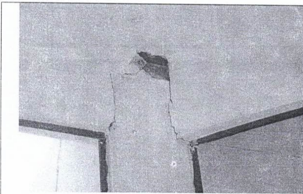
Foto 01: Descolamento do gesso, devido à infiltração.
