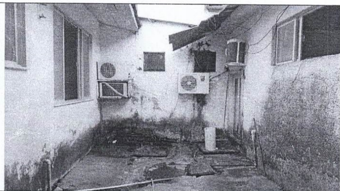
Foto 08: área externa precisando de reparos e pintura.
