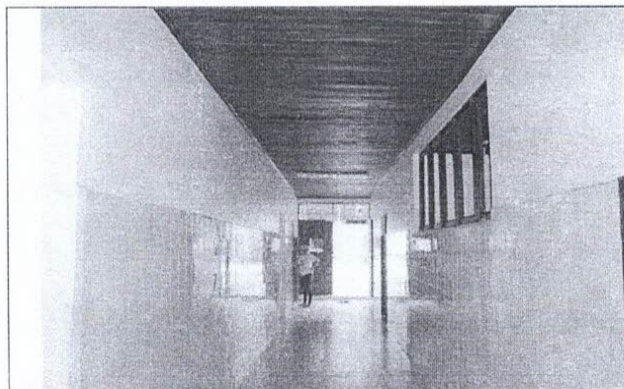
Foto 01: precisando de revisão e pintura no forro, assim como revisão nos pontos elétricos e se possível acrescentar mais pontos de iluminação.
