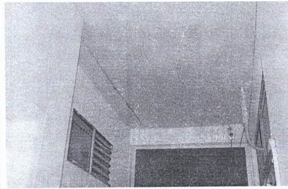
Foto 02: Área de circulação da administração, forro com infiltração.
