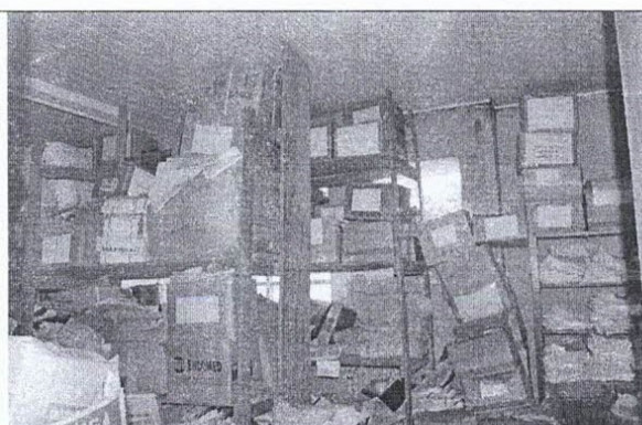
Foto 02: salas do pavimento superior servindo de arquivo, apresentando infiltrações entre o forro e parede.
