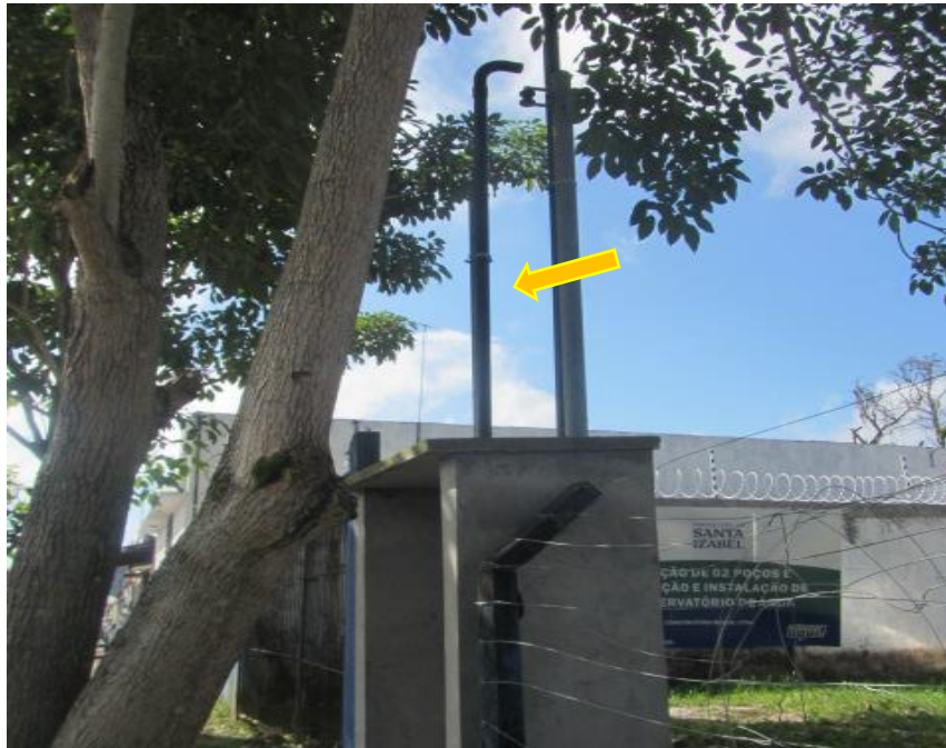
Foto 7: Vista Interna da área externa do terreno. Eletroduto pra entrada de cabeamento de energia.
