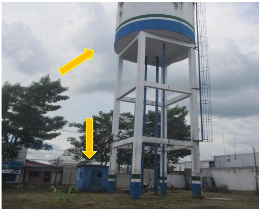
Foto 5: Vista pelo fundo do terreno do sistema de água. Castelo D'água de 100m 3 e abaixo em azul, casa de bomba e energia.
